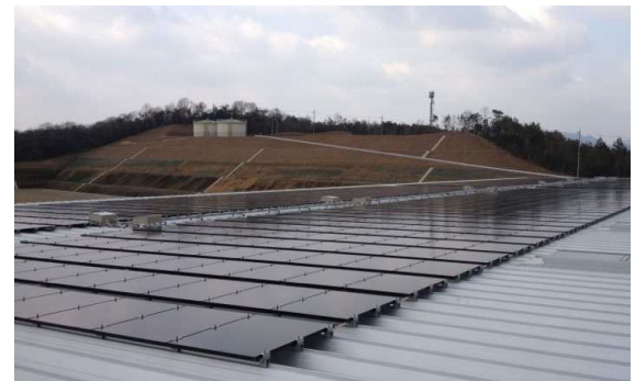
屋上に設置した太陽光発電パネル
